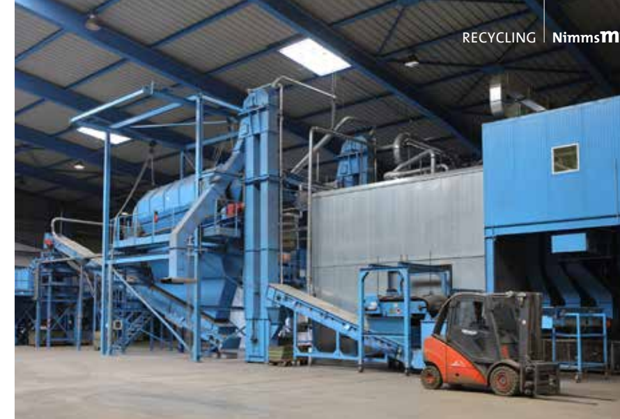
Eine mechanische Aufbereitungsanlage für Elektrokleingeräte und komplexe Verbundmaterialien.
